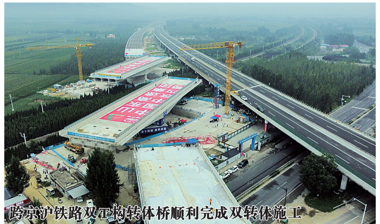
8月9日，跨京沪铁路双T构转体桥开始转体。当日9时25分，由中铁四局集团承建的京台高速泰安至枣庄段改扩建项目跨京沪铁路双T构转体桥，经过60分钟逆时针旋转后，在空中实现精准对接，较计划工期提前1个月完成了双转体施工，为加快实现全线双向八车道通车奠定了坚实基础。
