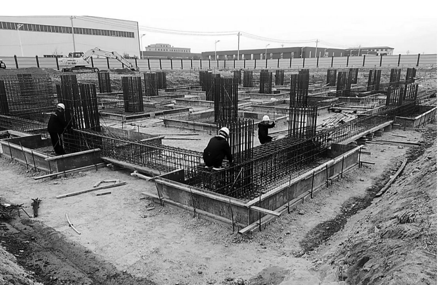
日前,在渤海新区黄骅市南大港产业园区无人机研发制造基地及人工智能装备制造项目现场,建筑工人身影忙碌。
