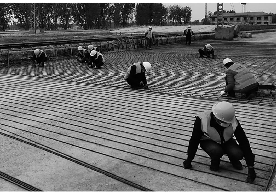
连日来，中铁四局三公司肃宁部的员工冒着严寒，加紧河间货场改造项目的建设，全面提升货场的装卸能力及作业效率，打造绿色环保、作业高效、设施完备的现代化综合物流站点。 据了解，朔黄铁路公司沿线货场综合改造工程覆盖594公里朔黄线，辐射76公里黄万线和216.8公里黄黄线，将成为高质量朔黄铁路大物流集疏运网络的重要保障。 边志强 摄
