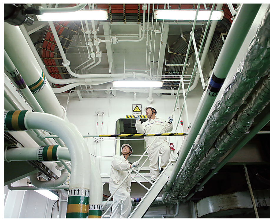
设备巡查时，船员总要穿梭于管道纵横的设备舱。
