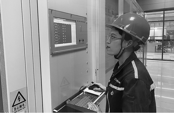
电子间安全检查
