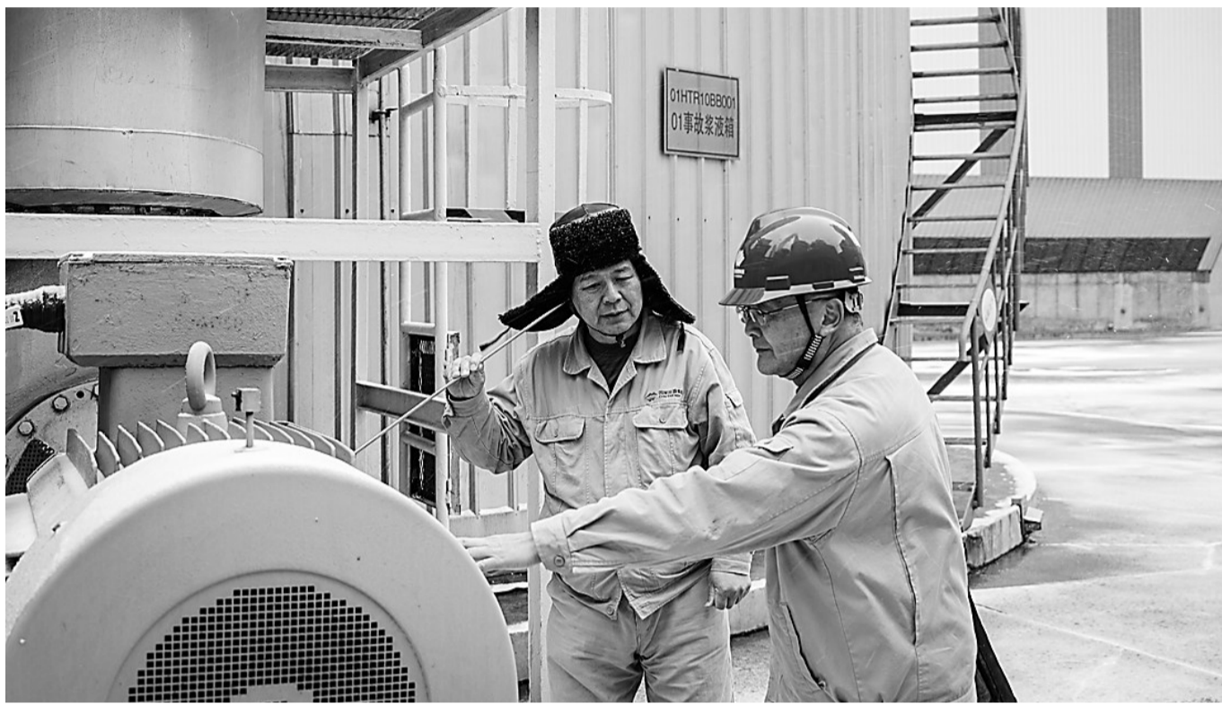
面对连日来的寒冷天气，沧东电厂对热网循环泵、管道、热网计量装置等重点设备进行安全检查，提升供热能力和供热可靠性，确保渤海新区黄骅市港城产业园区居民温暖过冬。 田水鑫 李智力 摄
