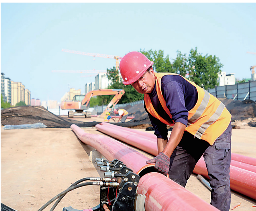
5月20日，在劝学路贯通工程（沧县段）施工现场，工人正在对电力排管进行热熔连接。
