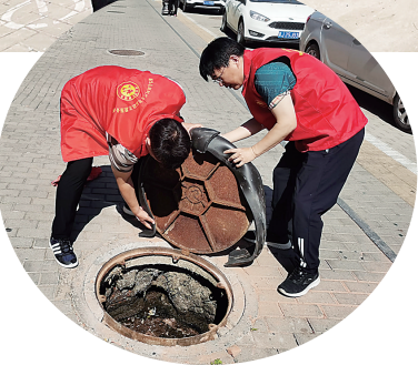
▲邻长主动修理小区破损井盖
