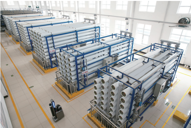
纯水膜车间机器人巡检
