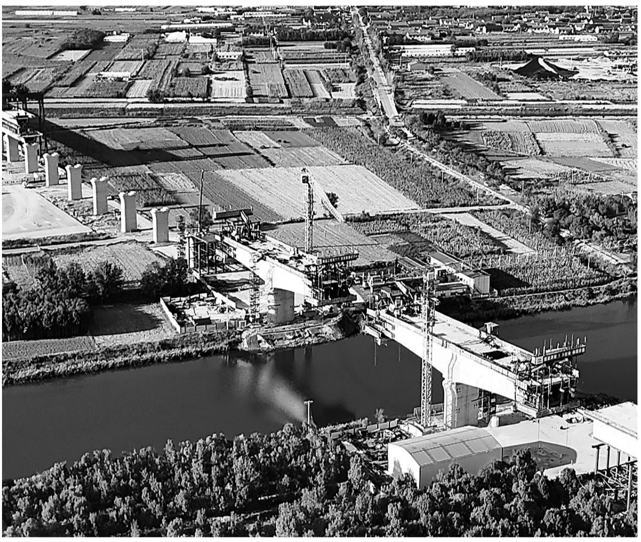
连日来,由雄安高速铁路有限公司负责建设、中铁十五局集团承建的天津至潍坊高速铁路海兴特大桥工程正在加速建设中。李俊鹏 孙晓卉 摄
