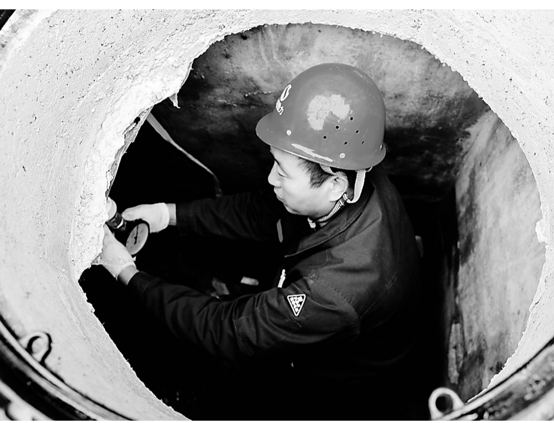
为保障群众温暖过冬,肃宁县住房和城乡建设局对相关工作提前部署,供热单位对供热设施设备进行检修维护。图为工作人员巡查供热管网支管网。 刘巨雷 摄
